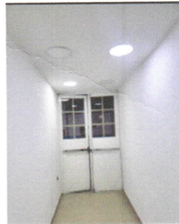
Pasillo Planta (Luminaria dañada)
