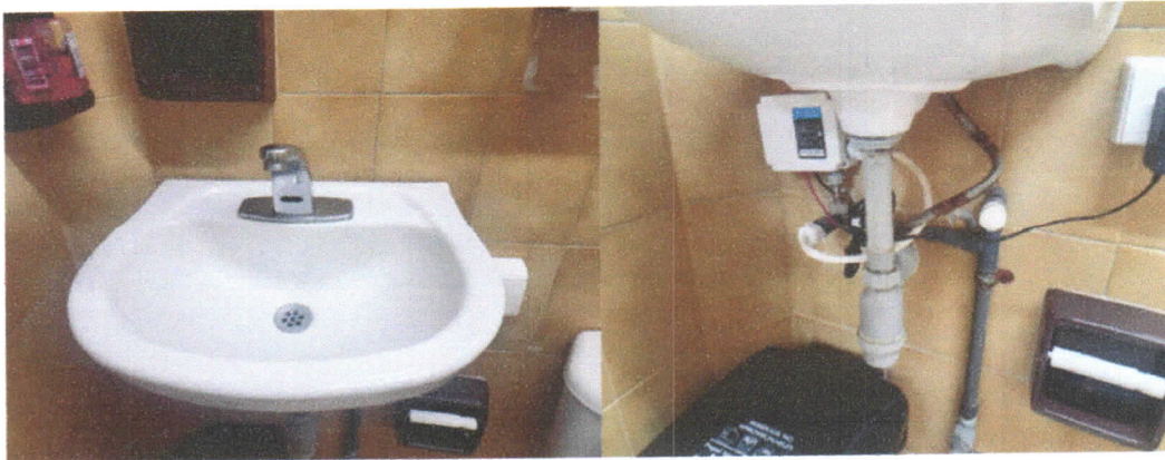
Lavamanos Oficina Jurídica (sistema ahorrador de agua)
