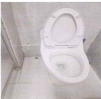
Baño de Hombres área de la planta (presenta goteo)
