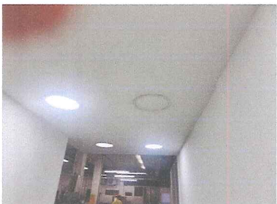
Pasillo entrada de la planta (luminaria dañada)
