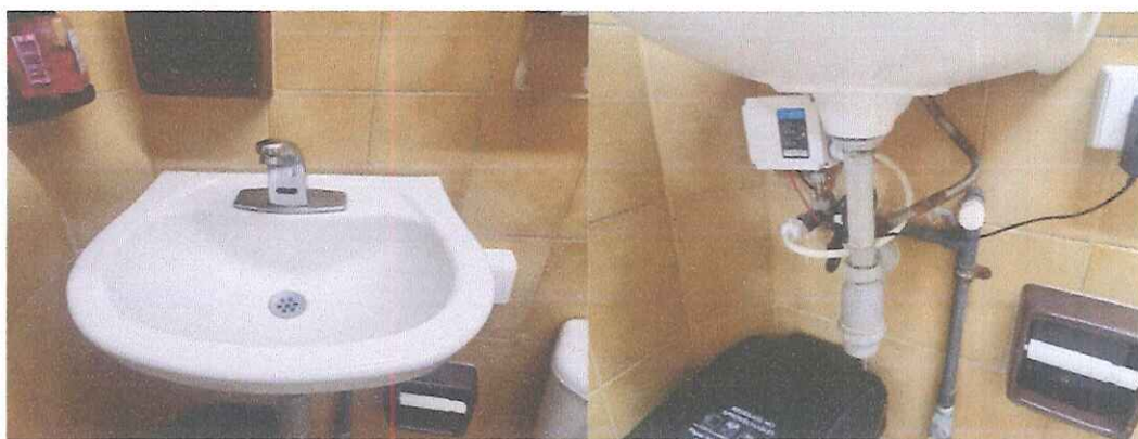
Lavamanos Oficina Jurídica (sistema ahorrador de agua)
